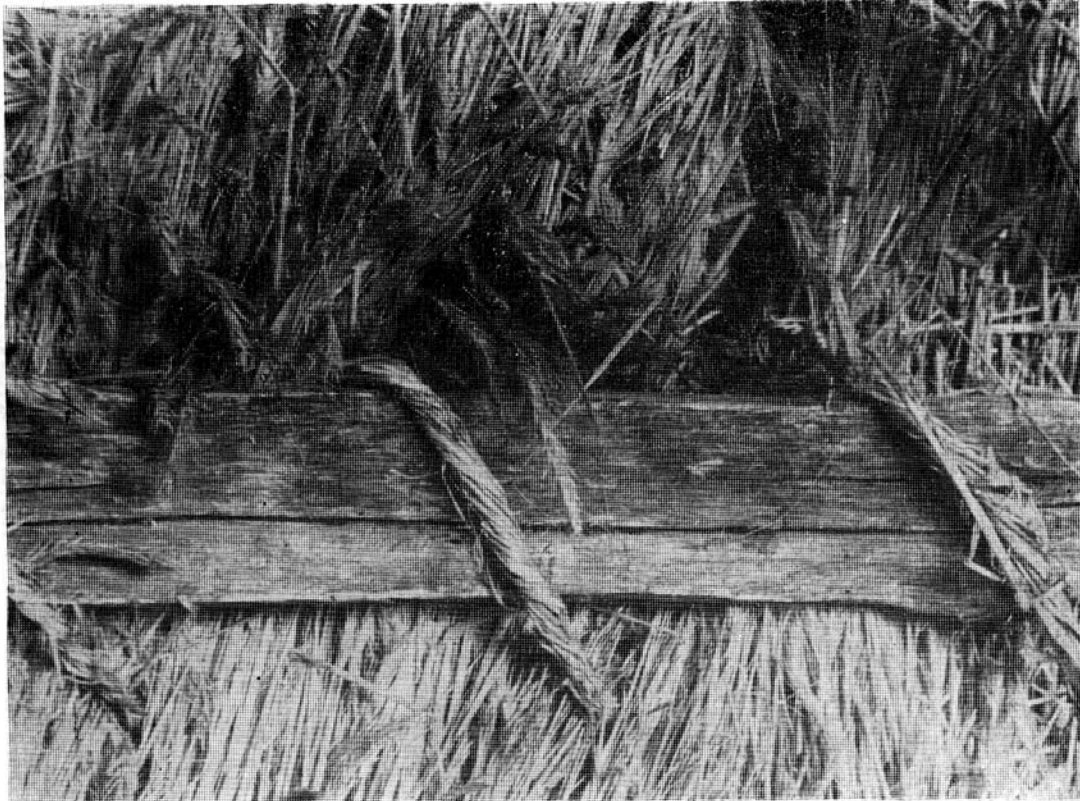
44. Nagy Jánosné (Székelyszentlélek) zsúpos csúrének fedélsíkja belülről. A kalászzal felfelé álló eszterhéjzsúpok kereszties rögzítése lent sodort kötéllel
