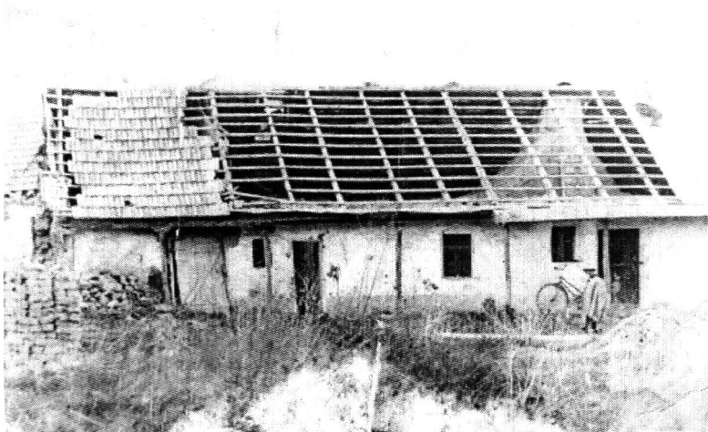
Kubola László egykori lakóháza bontás alatt. A mézárszék az utcára néző helységben volt
